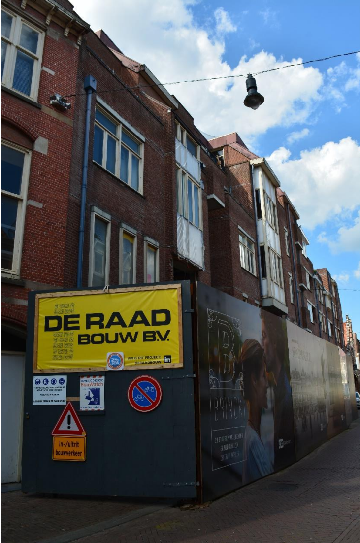
DSC_00022665 ; AV ; 2-9-2020 ; Smedestraat nabij de Grote Markt, gezicht richting noordwest op het begin van de sloopwerkzaamheden van het vroegere Brinkmanncomplex.
